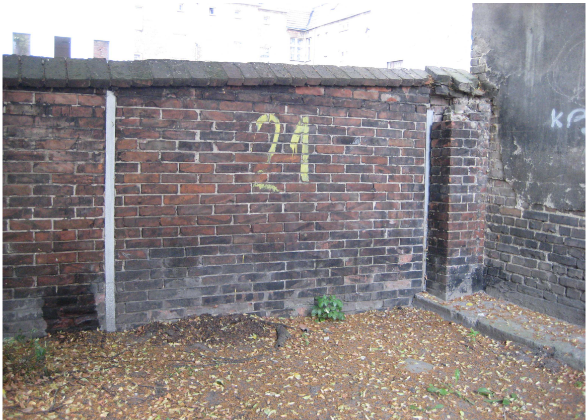
Fot. Nr 6 – Styk muru ze ścianą budynku oficynowego od strony działki Nr 12
