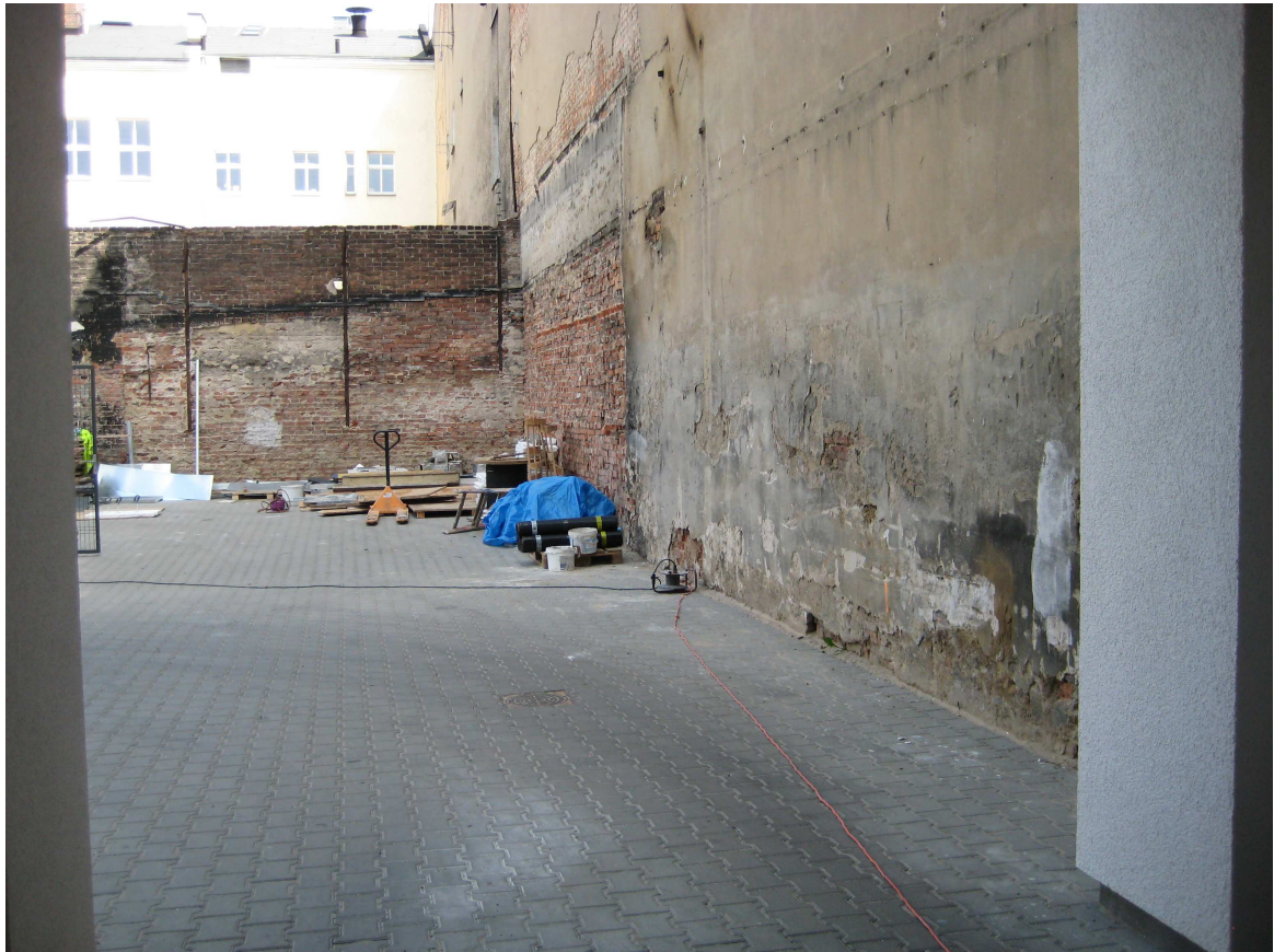
Fot. Nr 5 – Styk muru ze ścianą budynku oficynowego od strony działki Nr 16/3
