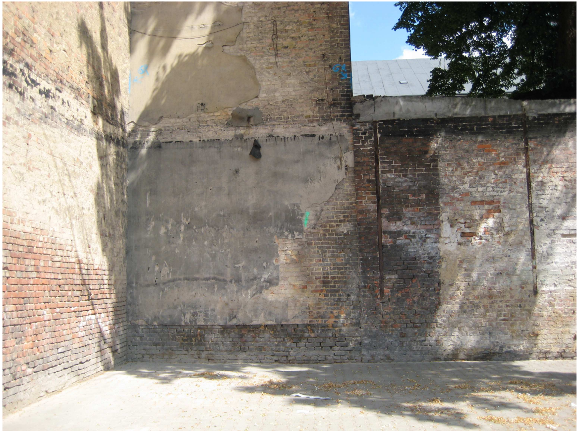
Fot. Nr 3 – Styk muru ze ścianą oficyny od strony działki Nr 16/3
