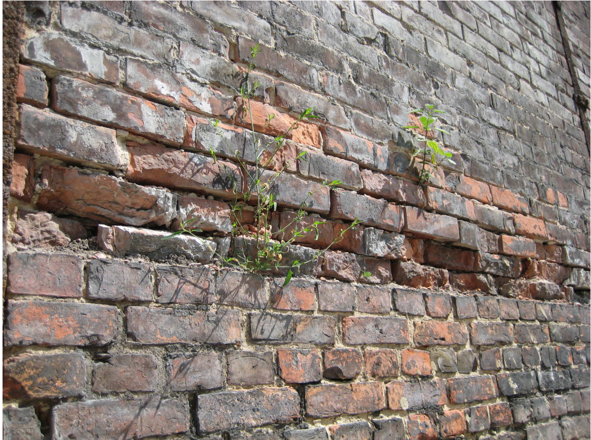
Fot. Nr 4 – Widoczne zmurszenia w strefie przemarzania
